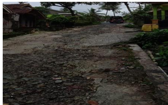
Gambar 2. Jalan yang rusak menuju Desa Cilentung Kecamatan Pulosari Kabupaten Pandeglang (Dok. Pribadi)
